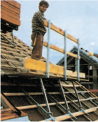
Echafaudage de toiture
