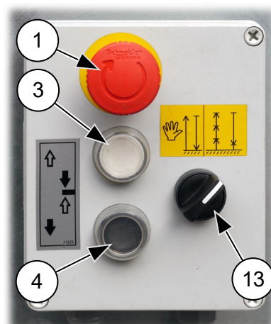
III. 48 – Commande au sol pour le dispositif de protection (AUTOMATIQUE)
