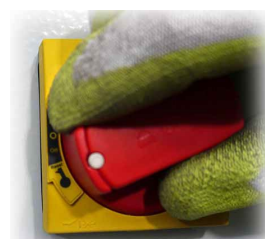
III. 62 – Réinitialisation du disjoncteur-protecteur
