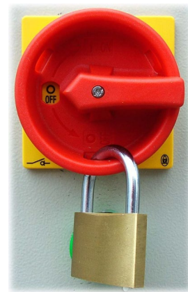
III. 62 – Interrupteur principal verrouillé
